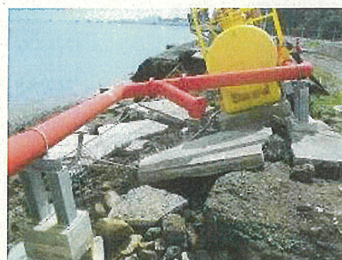
護岸等の崩落(横須賀地区)
