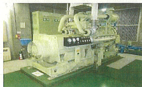
固定式非常用電源施設
